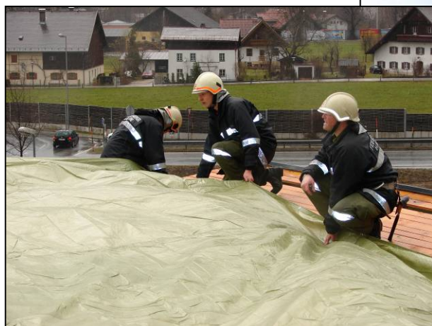
Große Schäden durch Sturm „Emma“ – 01.03.2008
